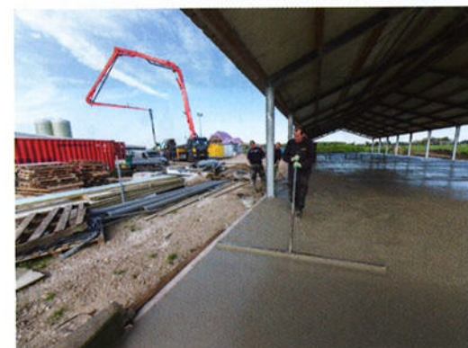
De 13 x 48 m grote voormalige bio-stal wordt bezoekersruimte en opslagloods. Ook de houtkachel komt er in
